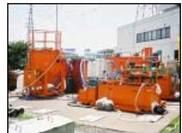
排水処理装置
