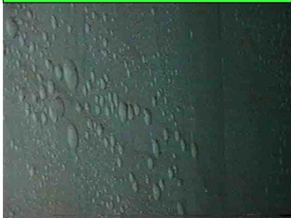
配水池点検 壁面部塗装膨れ状況
