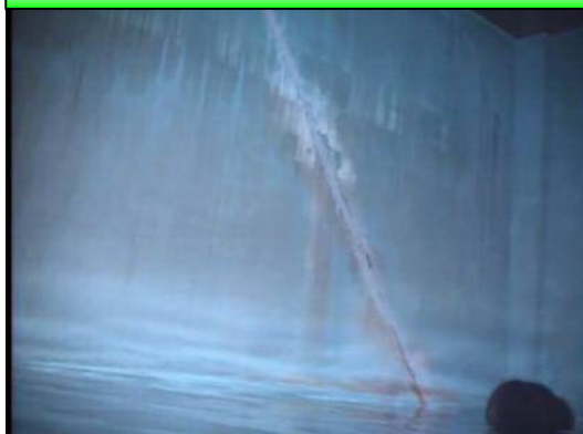
壁面亀裂上昇（気中）
