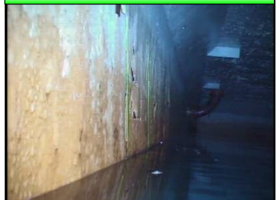
壁面塗装膨れ状況（気中）
