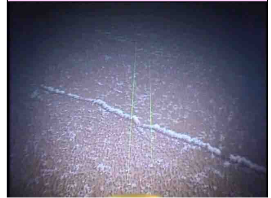
ラインレーザーによる亀裂寸法測定 (幅80mm)
