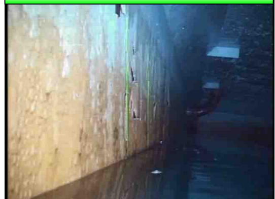
壁面塗装膨れ状況（気中）
