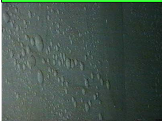
壁面部塗装膨れ状況
