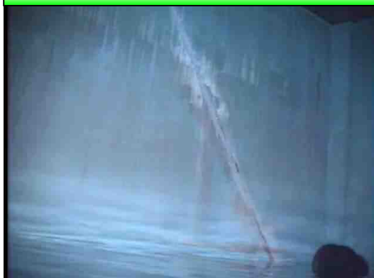
壁面亀裂上昇（気中）
