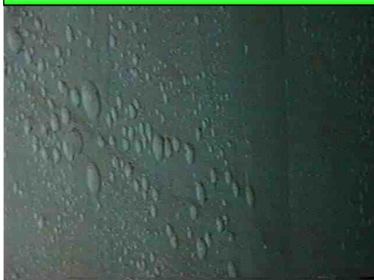
壁面部塗装膨れ状況
